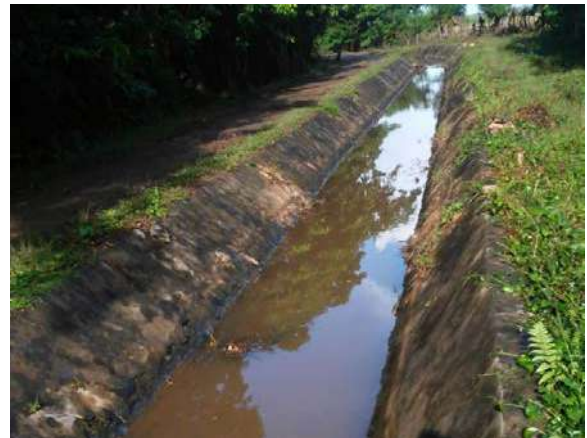
Trabajos de limpieza finalizados canal principal El Cedro en Miches, El Seibo.
