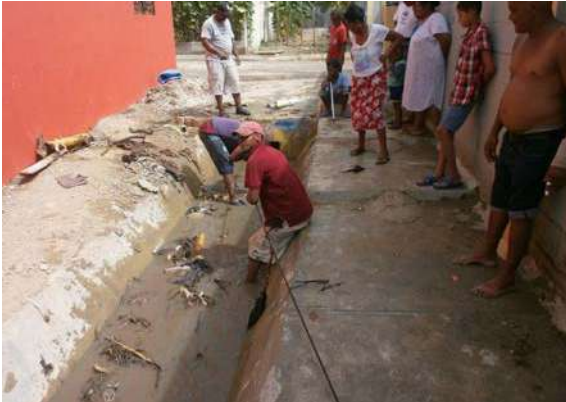
Limpieza del canal Las Lajitas en la zona urbana de Vicente Noble, Barahona.
